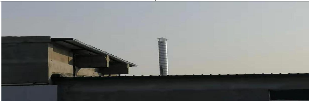
图 3-7 排气筒（内径 0.30m）
