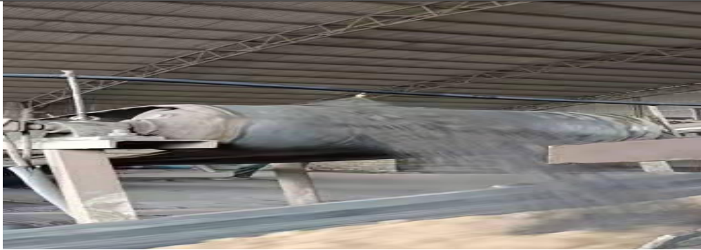
图 3-6 搅拌机（洒水抑尘装置）
