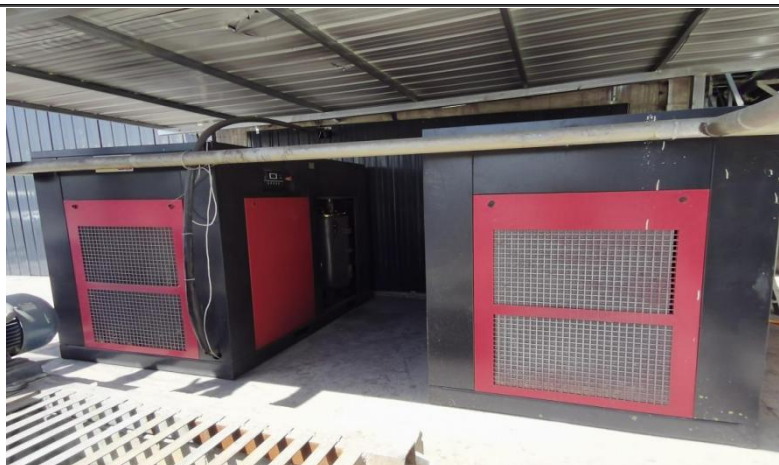
图3-12 封闭箱体空压机
